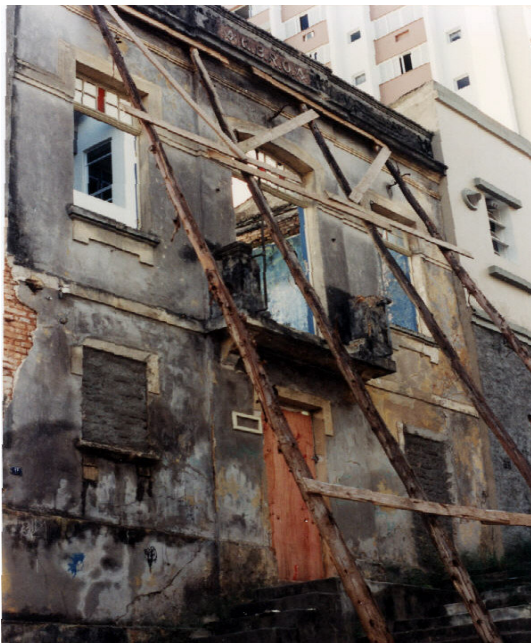
Fachada do prédio da União Operária, após o desabamento em 1992, com escoras colocadas pelo corpo de bombeiros, transformado em Teatro Municipal de Florianópolis. Foto: Vera Collaço. Fev. 1993.
